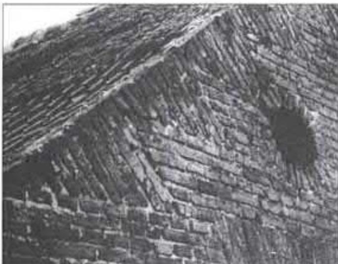
Vechtingen in het metselwerk.
